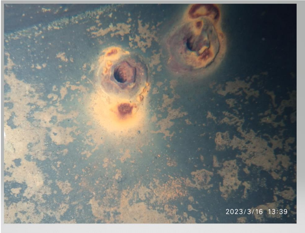
Figura 5: Tubulação oxidada na parte interna
