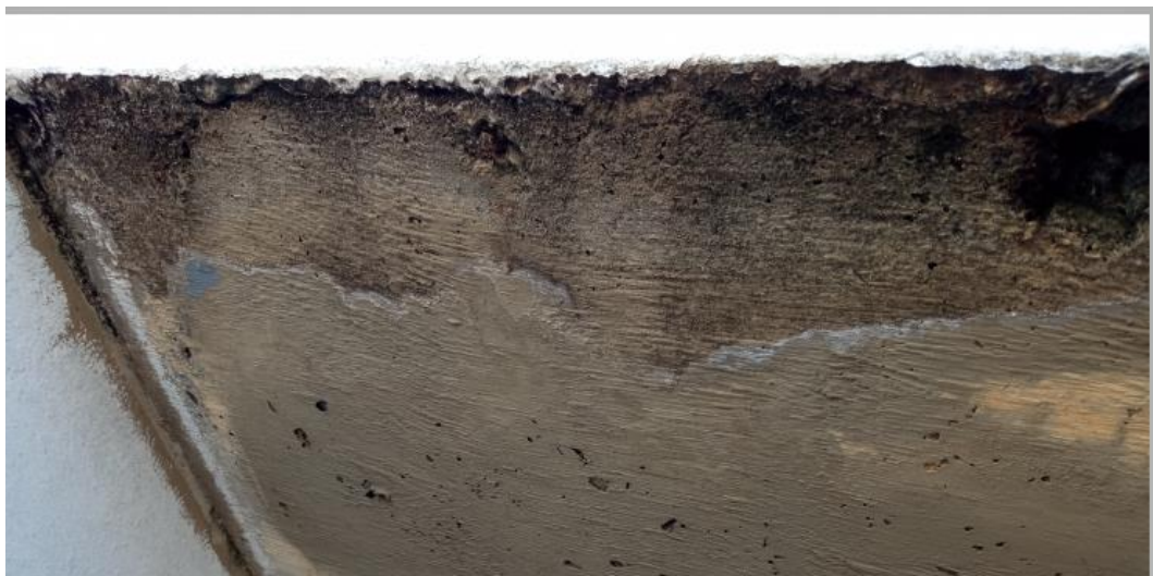
Figura 8: Visão inferior - infiltração
