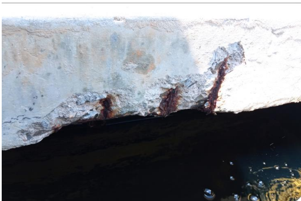
Figura 4: Patologias estruturais no alçapão
