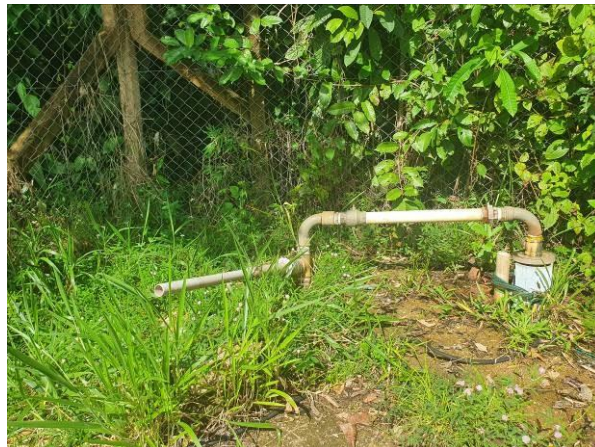
Foto 4: Poço 2 – Único poço operante atualmente.
