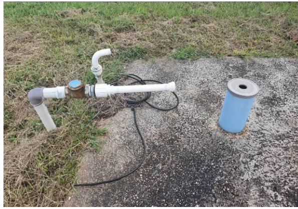
Foto 3: Poço 4 localizado nas proximidades do reservatório desativado devido à contaminação da água.
