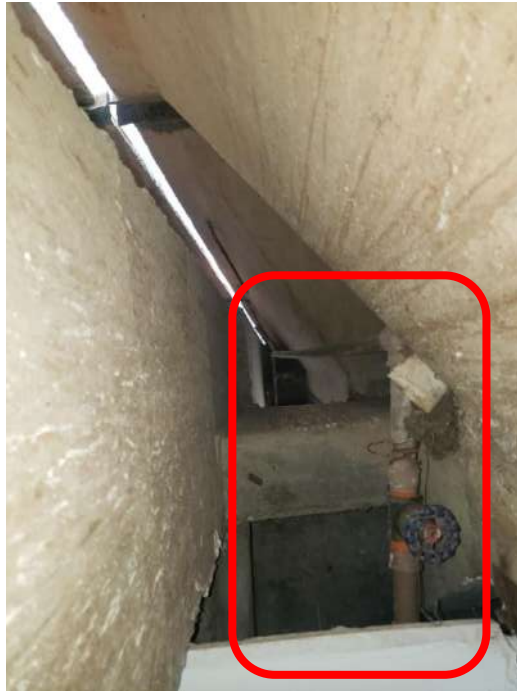
Figura 1 – Exemplo de trecho de tubo de alimentação de água fria em uma shaft
