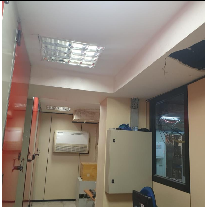
Figura 2 - Necessidade de reparo no forro da sala de Racks do CCA-BR
