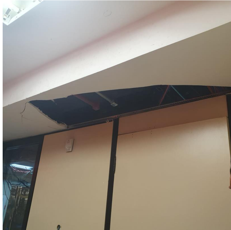
Figura 3 - Necessidade de reparo no forro da sala de Racks do CCA-BR
