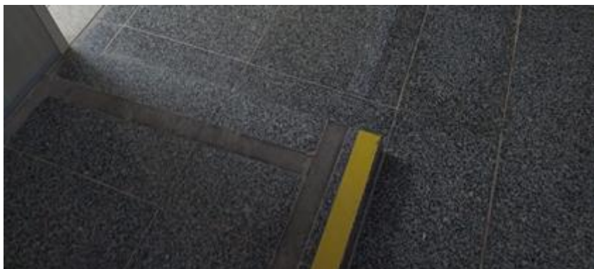
Figura 4 - Fitas antiderrapantes para indicação de desnível
