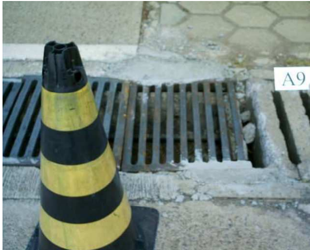
Figura 2 - Exemplo de foto apresentando caixa do bueiro quebrada gerando possíveis FOD na entrada do hangar.
