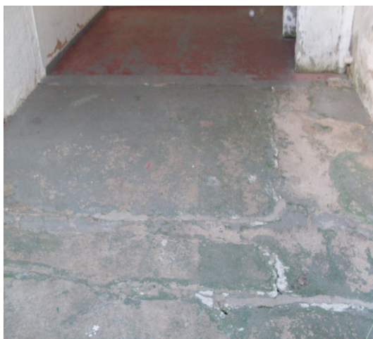
Foto 03 – Trinca existente em contrapiso.
